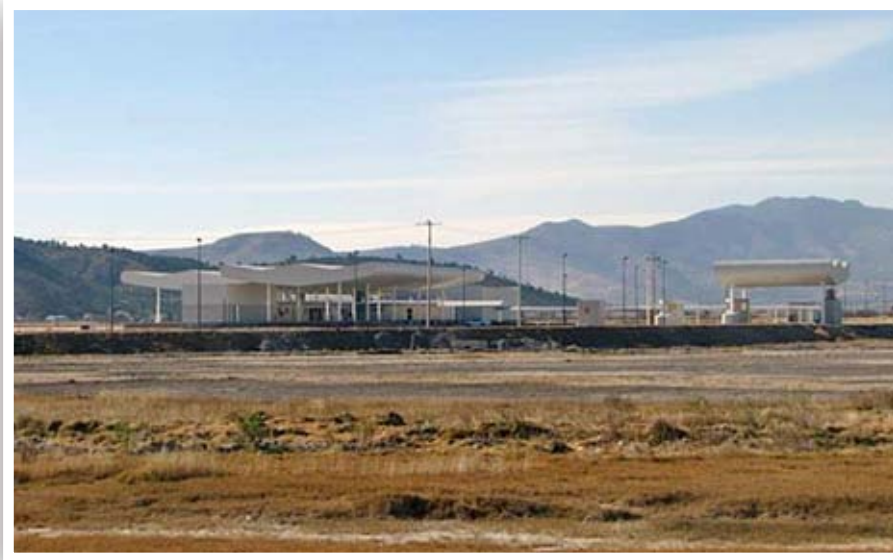
Figura 7.11 Construcción del Complejo Comercial La Célula en los municipios de Oriental y Tepeyahualco de Hidalgo (Foto: Carlos Castañeda Hernández).
